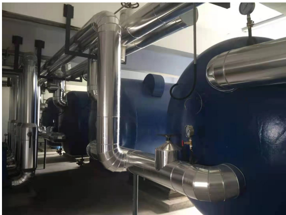
机房内蓄能器
